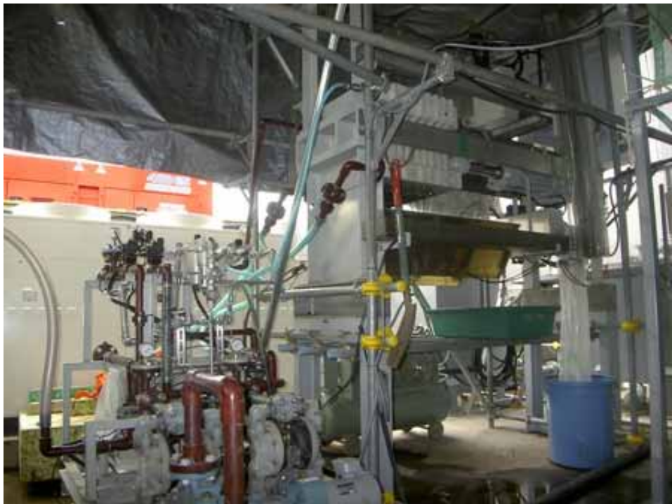
図6：一次固液分離工程用、濾過脱水装置(フィルタープレス)
