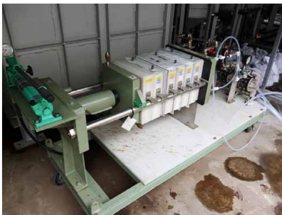
図8：二次固液分離工程用、濾過脱水装置(フィルタープレス)
