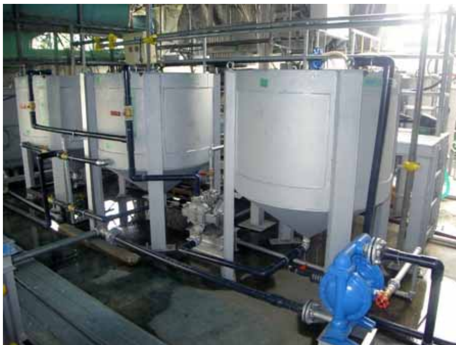
図7：吸着凝集沈殿処理用、反応槽及び沈殿槽
