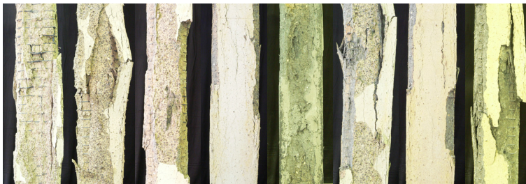
写真 荷重加熱実験終了後の試験体状況
