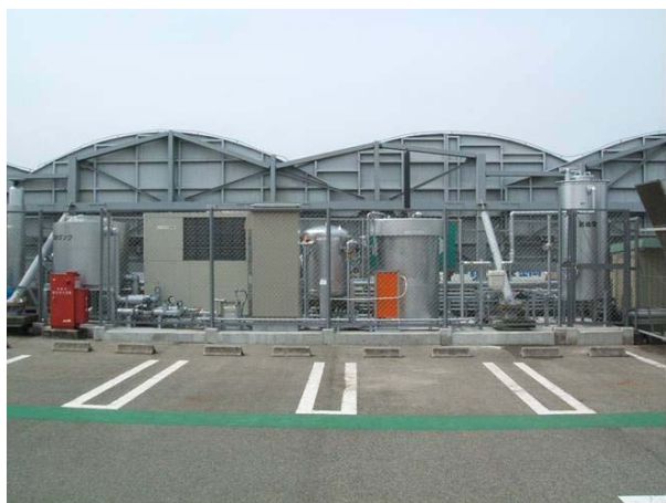
ガスエンジン設備
