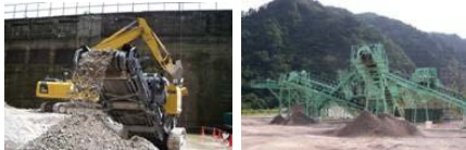
写真-1 再生骨材製造設備(左:破碎設備,右:分級設備)
