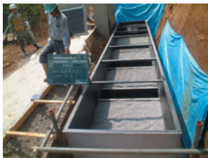
排水濾過槽（通水前）
