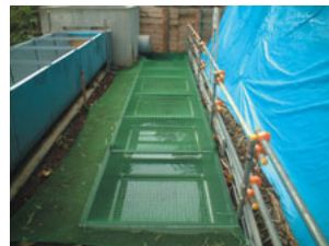
排水濾過槽（通水後）
