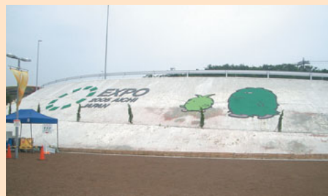
駐車場に位置する斜面の土砂流出を防止しています
