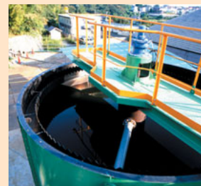
鉛除去水処理プラントで基準に満たない排水を処理
