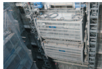
ダブルデッキエレベーター
