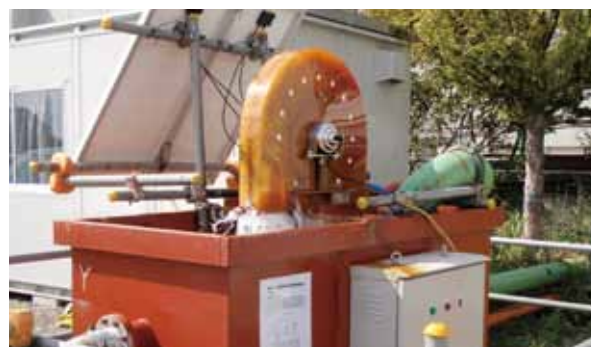
小型水力発電の利用状況(東京土木支店東尾久浄化センター作業所)
