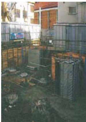
防音養生シート
