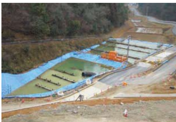
沈砂池の全景
