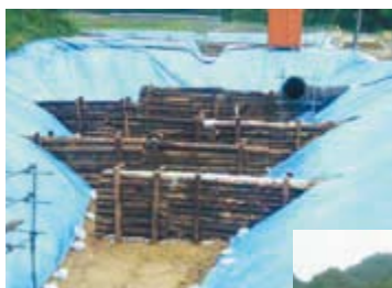
第1沈砂池の蛇行柵
