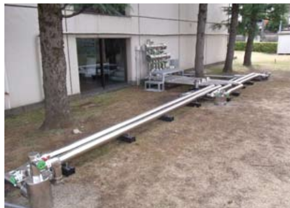
地中熱利用空調システム
