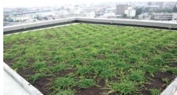
クラピアを用いた屋上緑化
