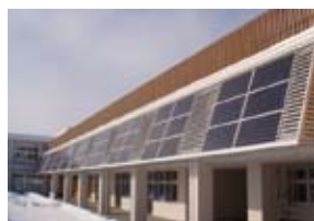
東根市立大森小学校に設置した太陽光発電施設
