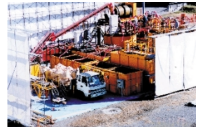
土壌洗浄法実証試験設備全景
