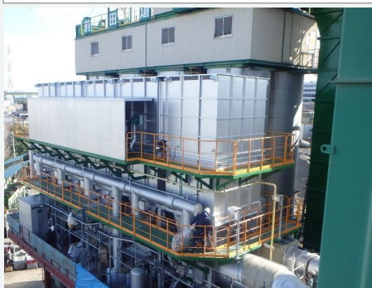
朝霞合材工場蓄熱燃焼式臭炉
