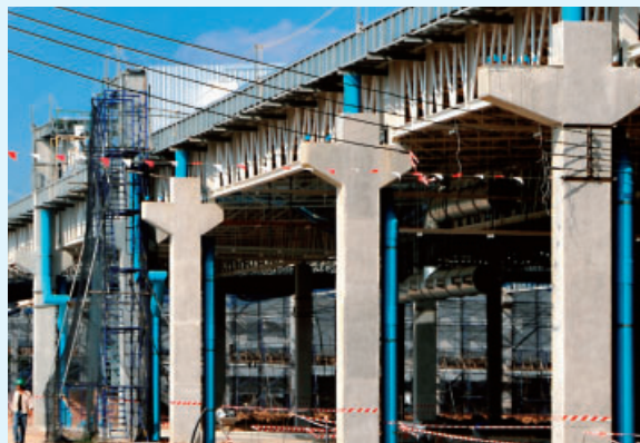
タイのスコールに対応する大型の雨樋と縦樋
