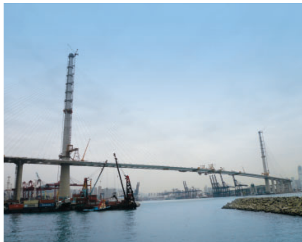
ストーンカッターズ斜張橋工事 香港にて平成16年4月より当社JVが工事に着手し、平成21年4月7日に閉合式典が開催されました。 表紙は完成時(本年10月)のCGです。
