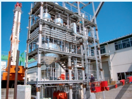
実証実験プラント全景
