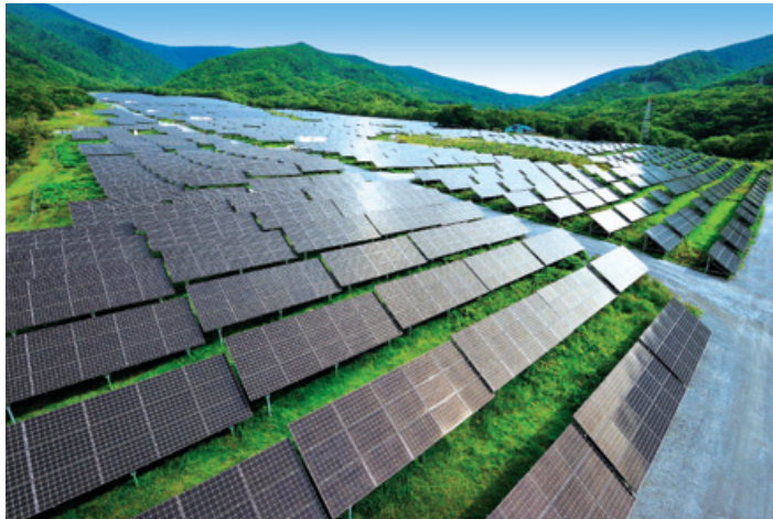
上：吹越台地風力発電所施設建設工事 下：五葉山太陽光発電事業発電所建設工事
