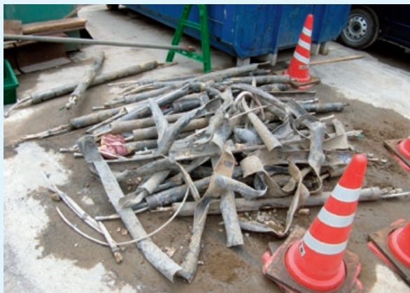
トンネルを掘削するために使用する鋼管の分別回収状況
