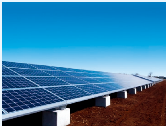
太陽光発電施設（茨城県つくば市）
