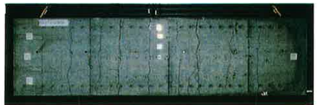
写真-2 ひび割れ状況(No.4)
