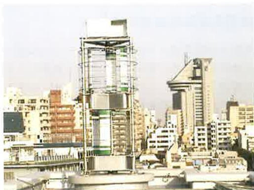
写真-2 屋上設置型風車
