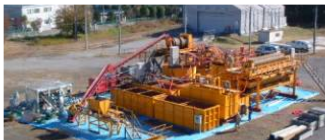
写真-1 プラント全景
