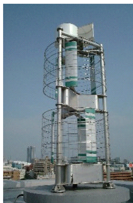
写真-2 春日マンション屋上の風車
