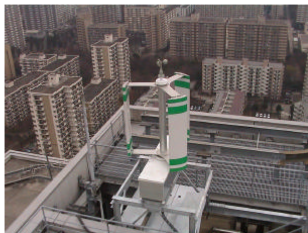
写真-6 J-city 屋上装置
