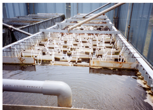
図-10 接触酸化槽内に設置された人工ゼオライト不織布
