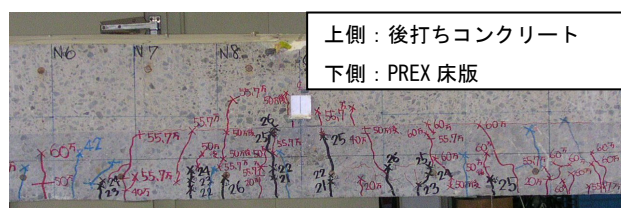
写真-7 梁疲労試験後のひび割れ状況
