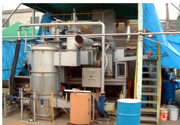
写真- 2 大型処理装置
