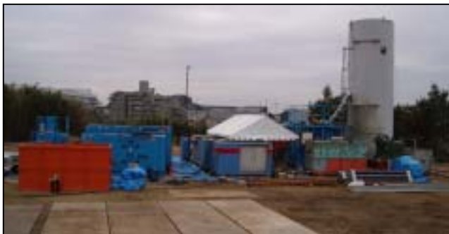
図-6 プラント全景
