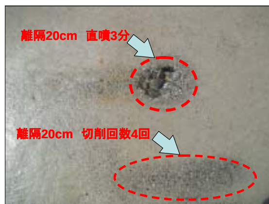
図-22 セグメント損傷状況(拡大)
