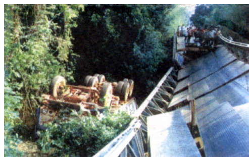
写真-1 崩壊した橋梁 4)
