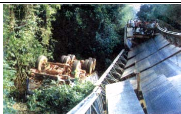
写真-1 崩壊した橋梁 4)
