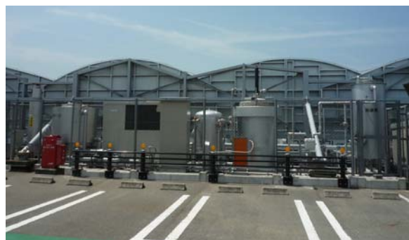
写真-10 屋上 ガスエンジン設備一式
