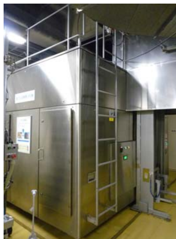
写真-5 生ごみ溶解槽 外観
