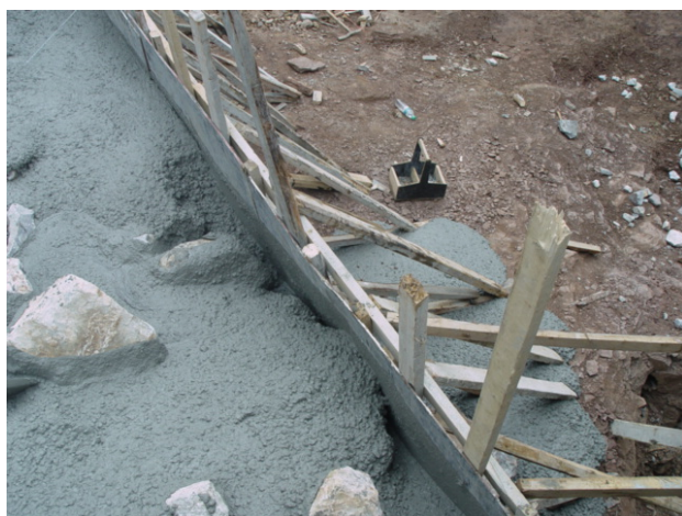
図-30 型枠内からSCCが外へ流れ出ている状況 2
