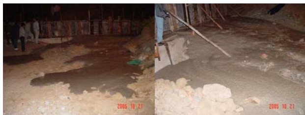
図-29 型枠内からSCCが外へ流れ出ている状況 1
