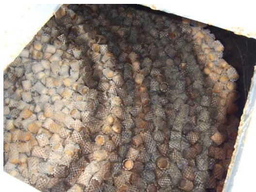
写真-8 DHS 内部のスポンジ
