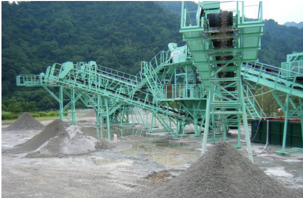
写真-4 粒度調整・分級設備
