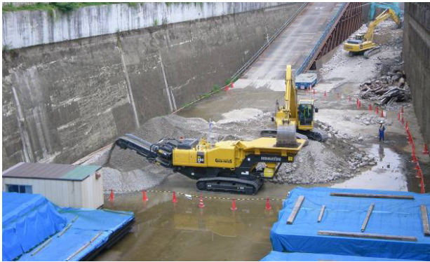
写真-3 再生骨材製造設備（一次破碎設備）
