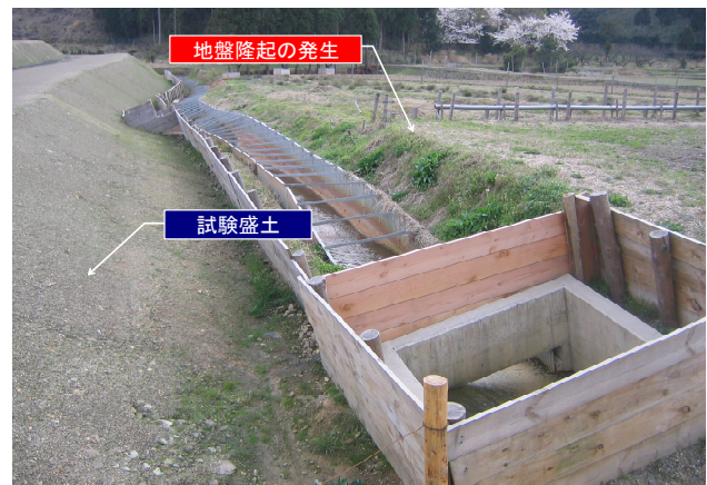
写真-1 試験盛土法尻付近の変形状況
