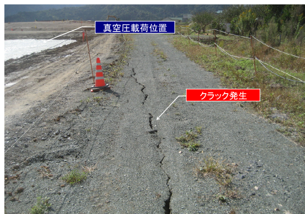
写真-5 地表面クラックの発生（鳥浜②载荷盛土）
