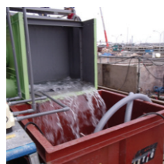
処理水発生状況(放流槽)
