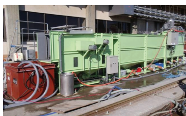
写真-7 設備設置状況(60m 3 /h 級)
