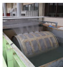
金網ろ過状況(分離槽)
