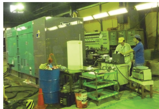
写真-3 発電機性能比較試験状況
