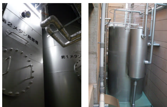
写真-2 メタン発酵槽（左：1階部、右：天端部）
