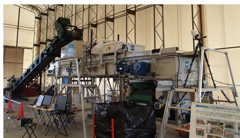
写真-13 土壤連続ソーティング設備の全景
