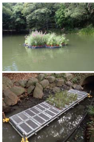
写真-1 (上) 植生浮島, (下) 礫間接触酸化槽
