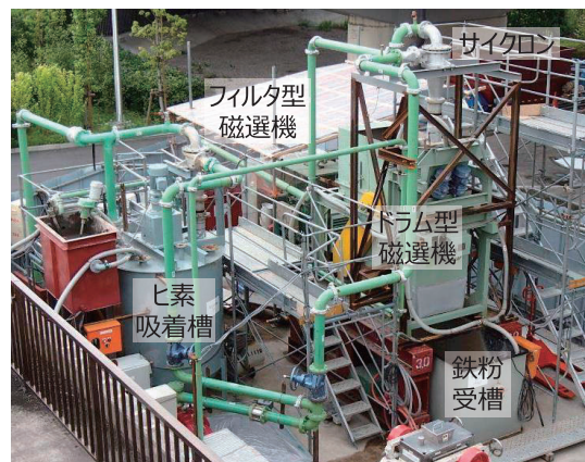
写真-1 実証プラント
