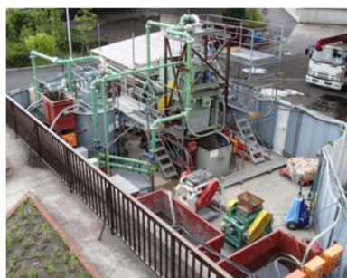
写真-3 実証プラント全景
