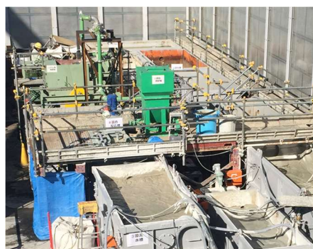
写真-5 浄化プラント設置状況
