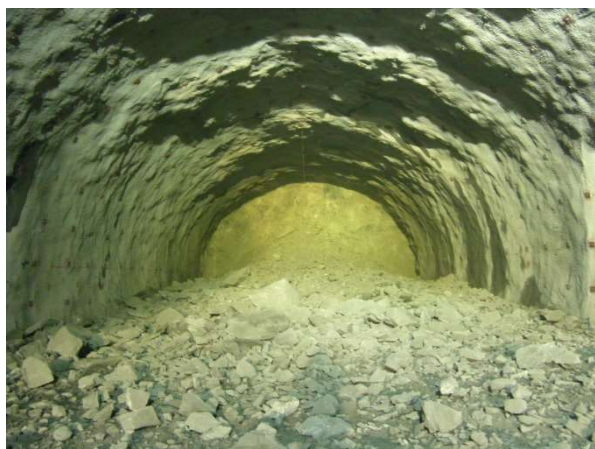
写真-17 岩塊飛散状況 (LP 雷管-多段発破時)
