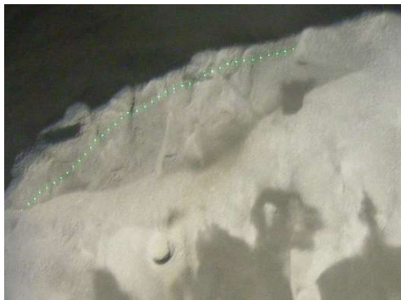
写真-7 自動追尾型レーザー断面照射システム
