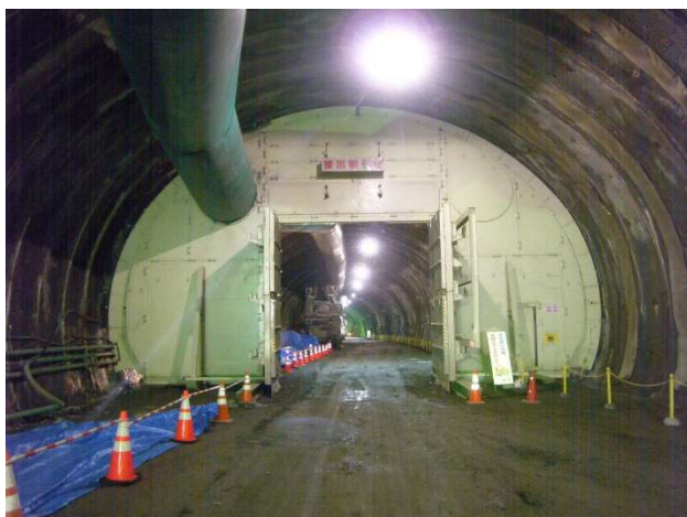
写真-15 移動式防音扉
