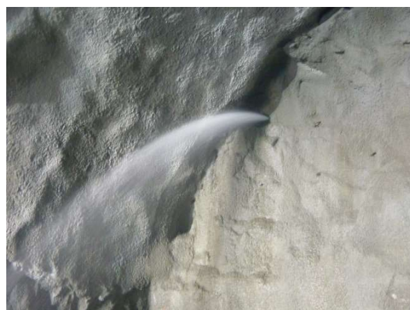
写真-19 切羽異常出水発生状況（TD1180m 地点）
