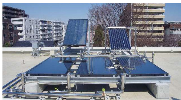
写真-1 太陽熱集熱器
