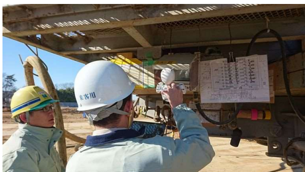
写真-4 供給電源電圧値の読み取り
