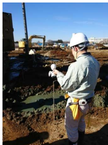
写真-3 OriHime による汚泥の確認
