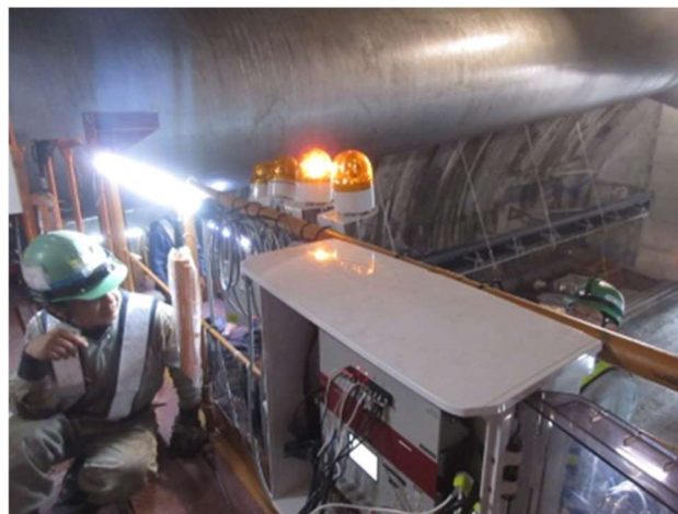
写真-7 警告灯の作動状況
