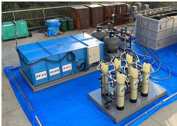
写真-3.1 水処理装置「De-POP's ION ® 」全景
