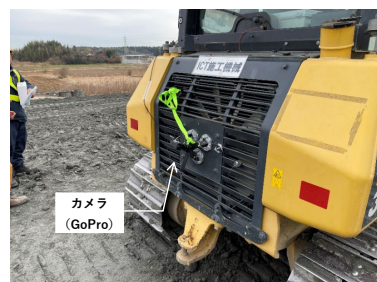
写真-5 カメラの設置状況
