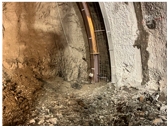
写真-9 脚部接触状況
