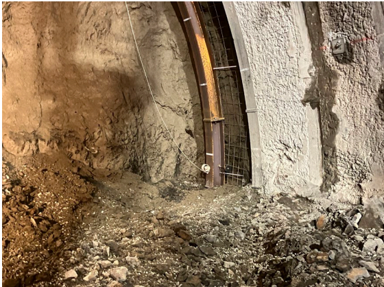
写真-9 脚部接触状況
