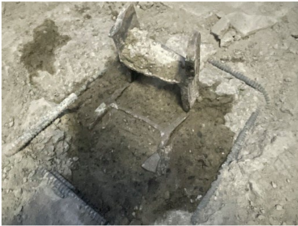
写真-2 主鋼材の破断面（基部のワイヤーソー切断面より 100～150mm 下の破断面）
