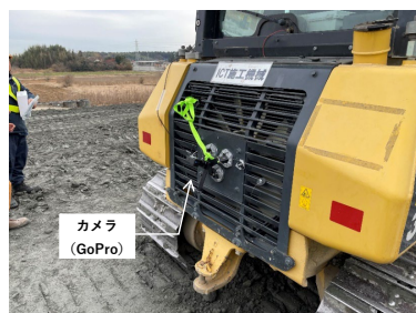
写真-5 カメラの設置状況
