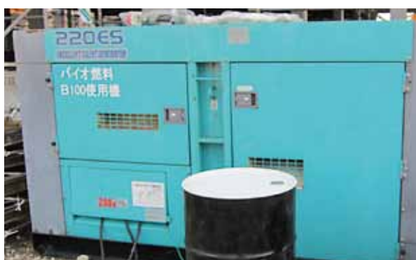
発電機へのBDFの適用例(東京建築支店京橋ビル作業所)
