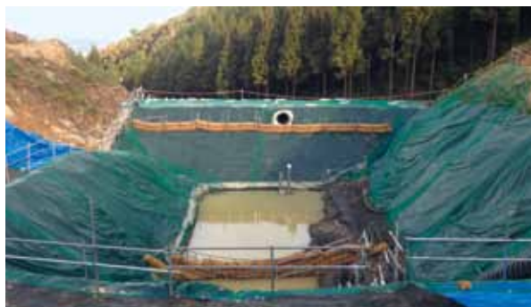
水処理プラントの負荷低減のために設置された集水池 (関西支店島根原電造成作業所)
