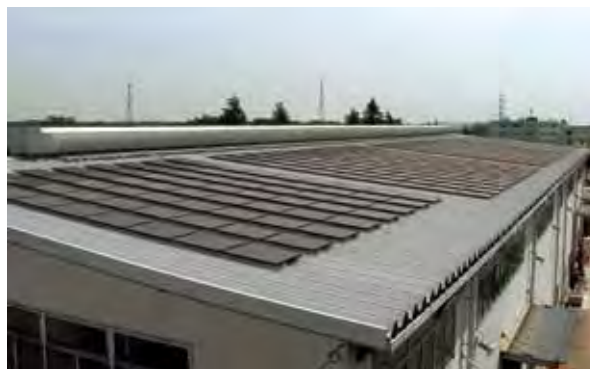
工場の屋根に設置している太陽光パネル
