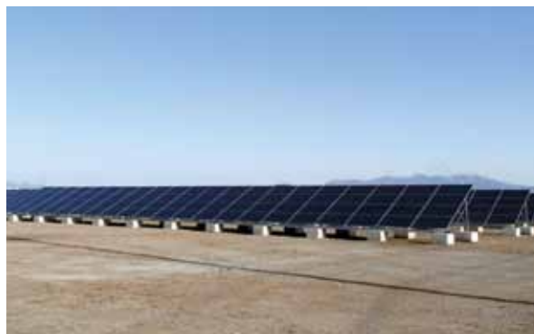
太田リケン太陽光作業所に設置した太陽光発電施設
