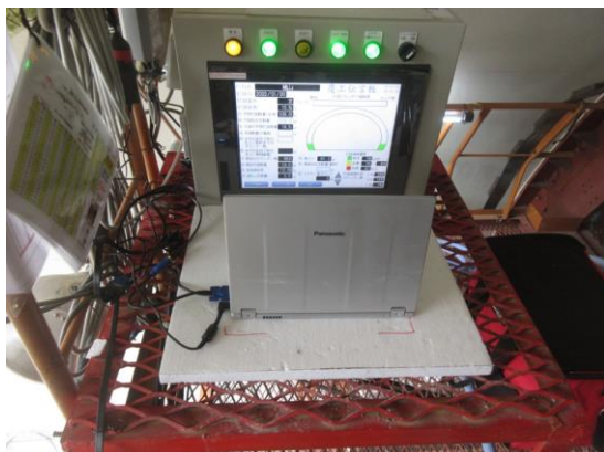
覆工伝言板設置状況
