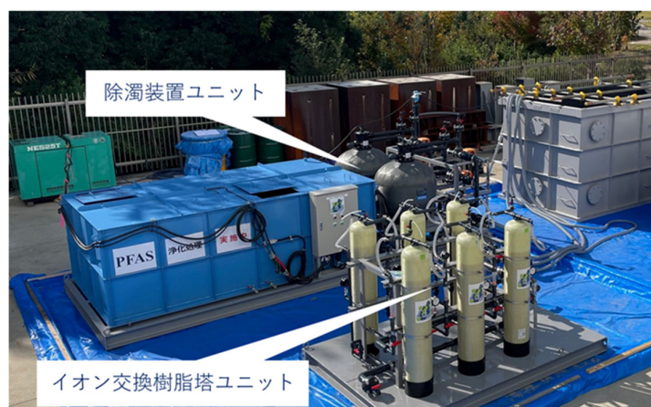
写真1 「De-POP's ION®」設置状況
