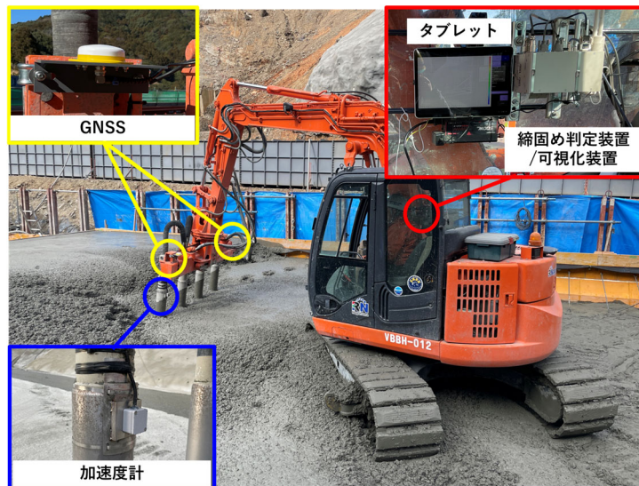
写真-1 締固め品質管理システム
