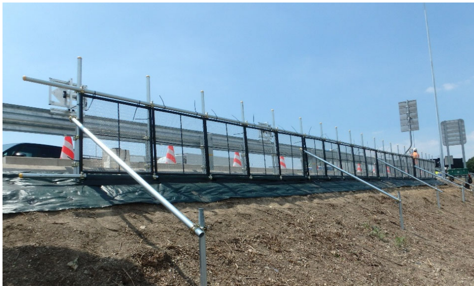
写真2 発電電力を雑草抑制装置「WCP(Weed Control Panel)」へ活用
